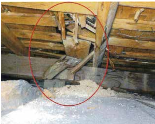
軒先化粧材に雨漏り跡、腐食が進む部分も 登り梁が継いであり軒垂れの原因に
