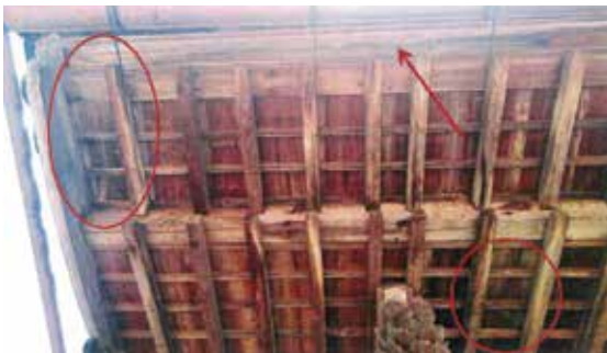
雨漏りによって野地板が折れた状態
