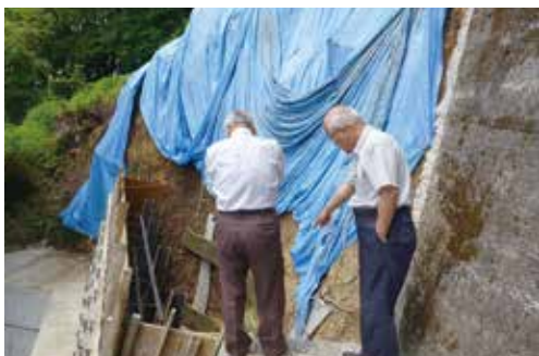
位牌堂裏のコンクリート老朽化
